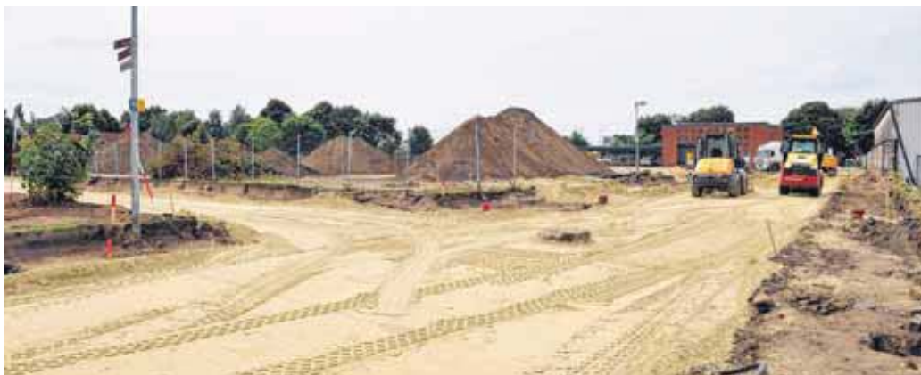
Komplett erneuert werden zurzeit die Zeppelinstraße, die Augustastraße und die Hafenstraße im Süden des NINO-Areals.
