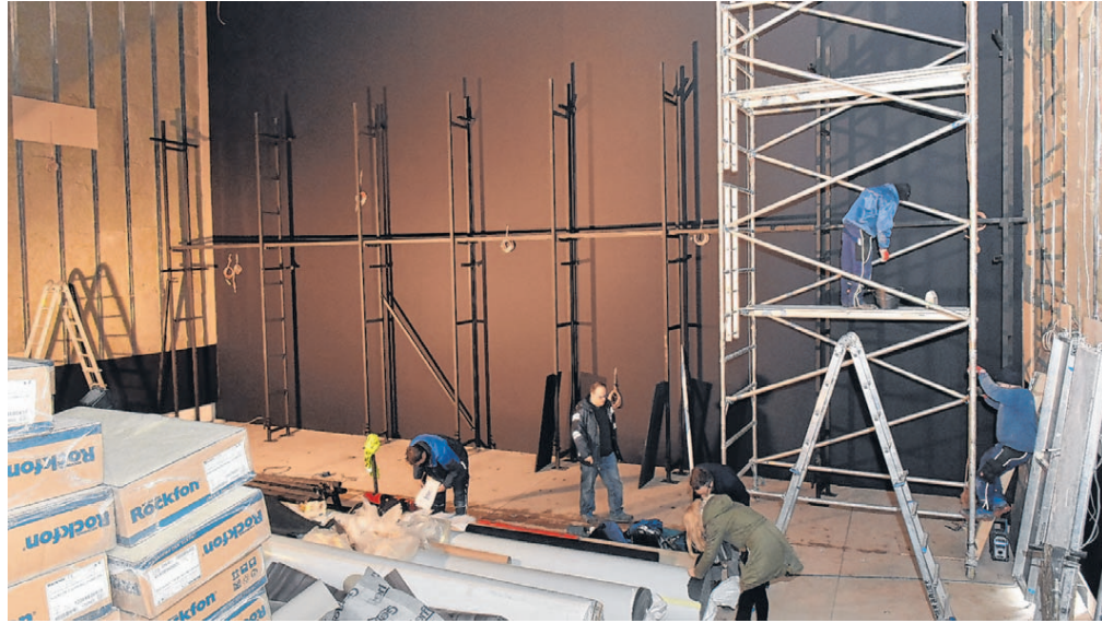
Die größte Leinwand im künftigen UCI-Kinozentrum bekommt der Saal 1. Dort montieren Fachleute gerade das Gerüst für die Leinwand, die in den nächsten Tagen gespannt wird.
